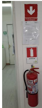
Extintor Comedor (Cocina)
