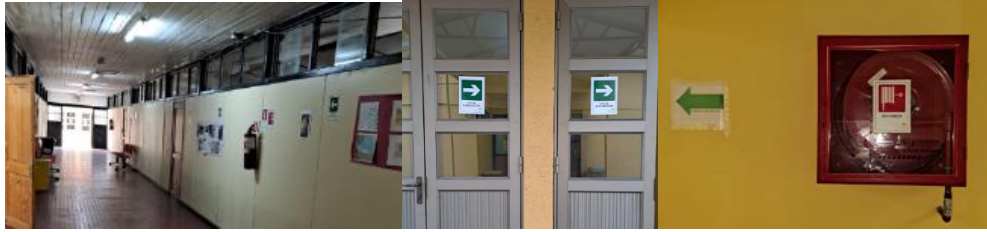
Extintores Pabellon Sur
