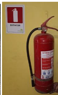
Extintor pabellon Norte
