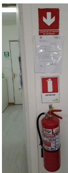
Extintor Comedor (Cocina)
